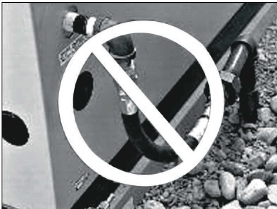
Рис. 5-4. Неправильно проложенный гибкий шланг.
